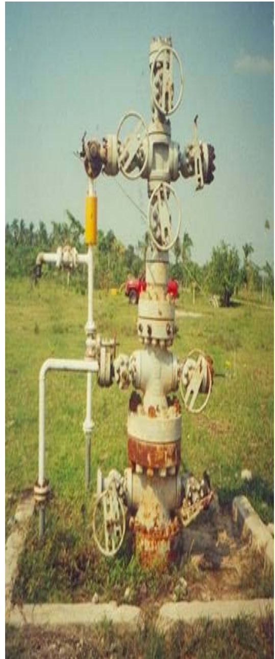
Figura 2.8. Árbol de válvulas
