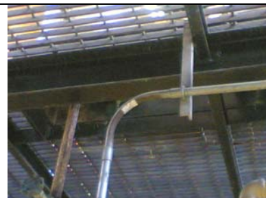
Soporte de ángulo para tubería aérea.
