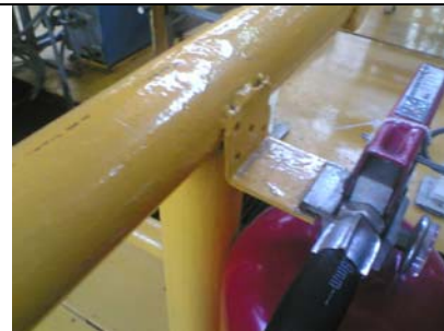
Soporte soldado a tubería
