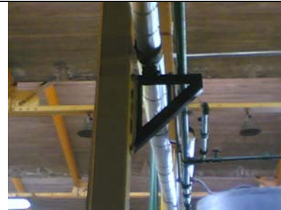
Tubería aérea de vapor y agua sobre ménsula de ángulo.
