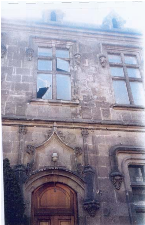
Lam 21 Deterioros en capelos de vanos.
