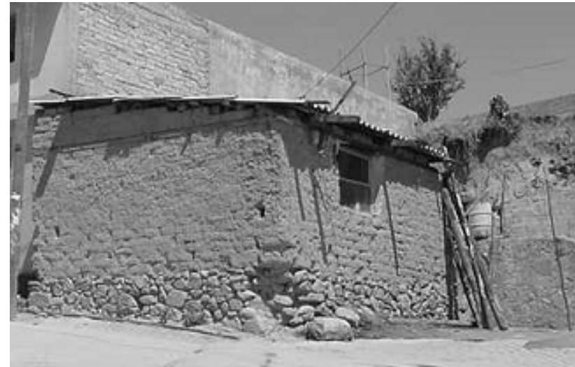
Fig. 9.3. Vivienda de mala calidad.
