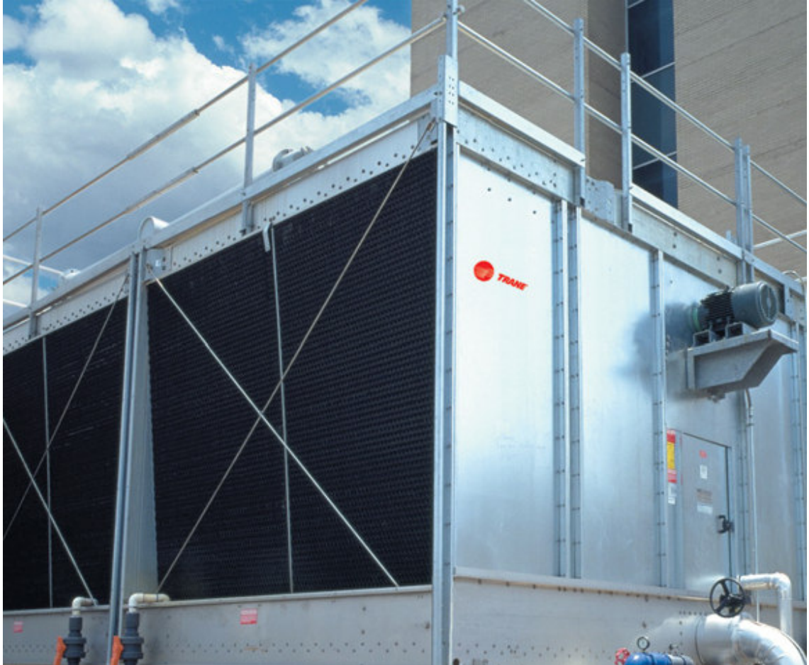
Ilustración 9. Torre de enfriamiento comercial
