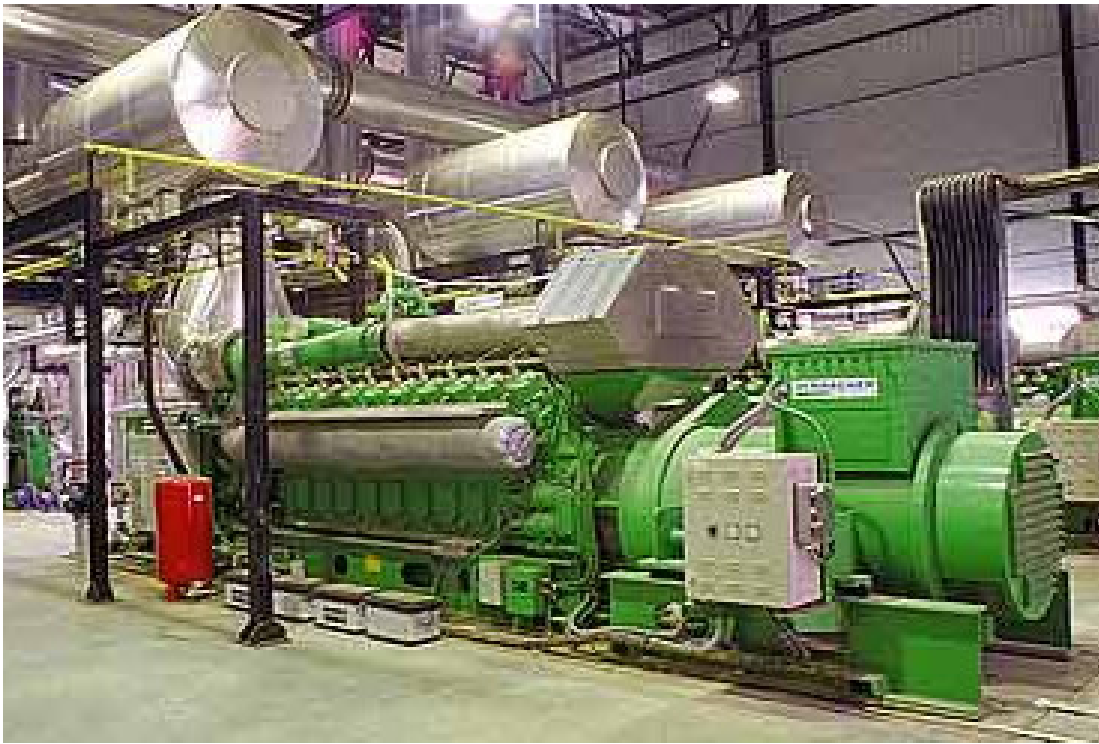
Ilustración 2. Motor Jembacher y generador.
