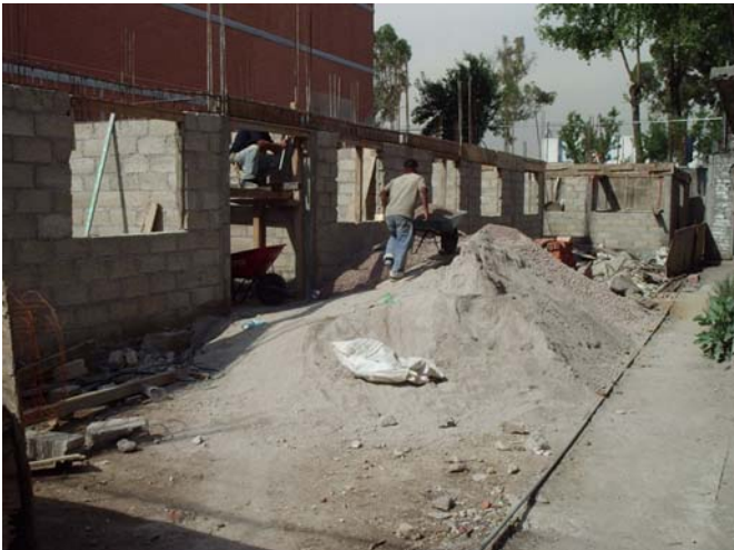
Proceso de la obra primer nivel en Corregidora No. 5 col. Santa Anita.
