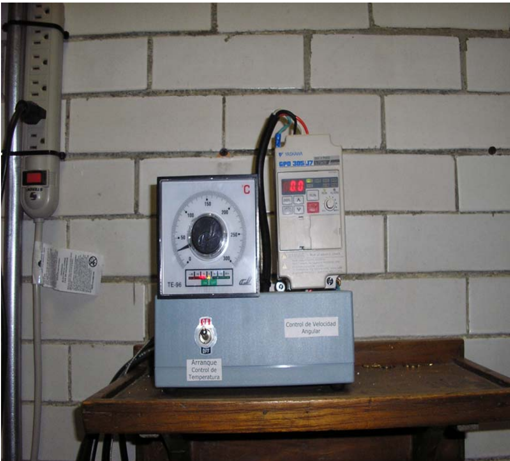
Controlador de Temperatura y Variador de Frecuencia para Motor del Ventilador.
