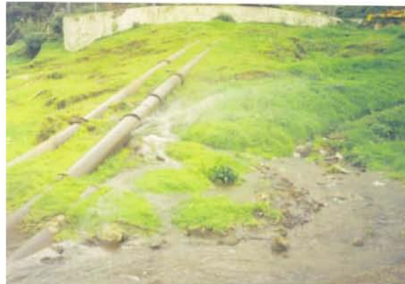
Las tuberías que se conectan al sifón en San Miguel Topilejo se encuentran en mal estado, provocando el desperdicio del agua. El Sifón. Rocío Martínez Guzmán. San Miguel Topilejo. 2003.
