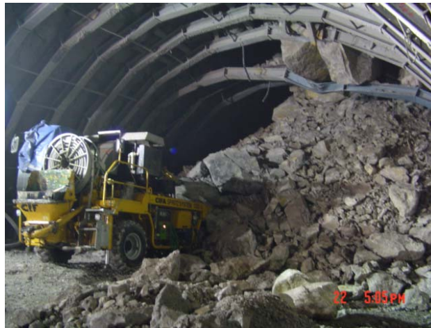
Figura 8.1 Inestabilidad de una excavación subterránea
