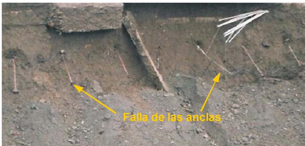
Figura 9.7 Falla del anclaje en un corte por defectos en la inyección
