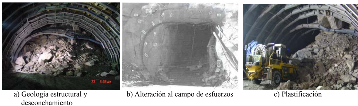
Figura 1.1 Algunos casos de fallas en excavaciones subterráneas
