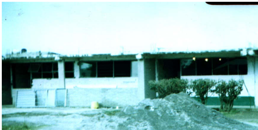
Fotografía 7. Para el año 2003-2004 se remodelaron los primeros salones, ahora cuenta con aplanado, instalaciones eléctricas, nuevas ventanas y puertas. Actualmente son ocupados por alumnos de tercer grado
