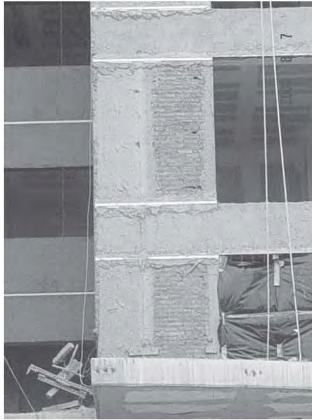
Fig. 4.4.6 Entrecalles y goteros colocados
