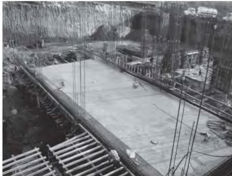
Fig. 5.3.4 Empleo de triplay para soportar la cimbra eje B al C y de 3 al 6
