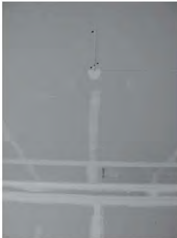
Fig. 4.2.2.23 Muro y plafón encintados
