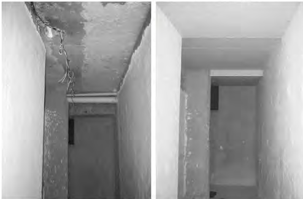
Fig. 4.2.2.16 Instalaciones eléctricas e hidrosanitarias ocultas en el plafón de baño
