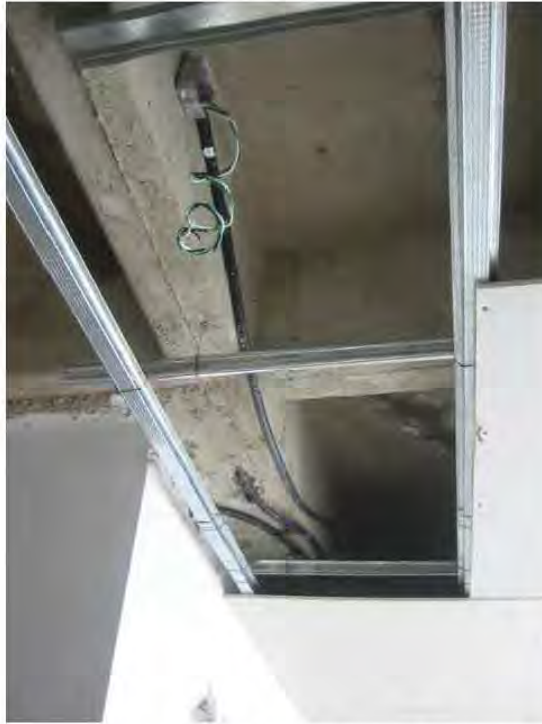
Fig. 4.2.2.15 Instalaciones eléctricas que se ocultaran en el plafón
