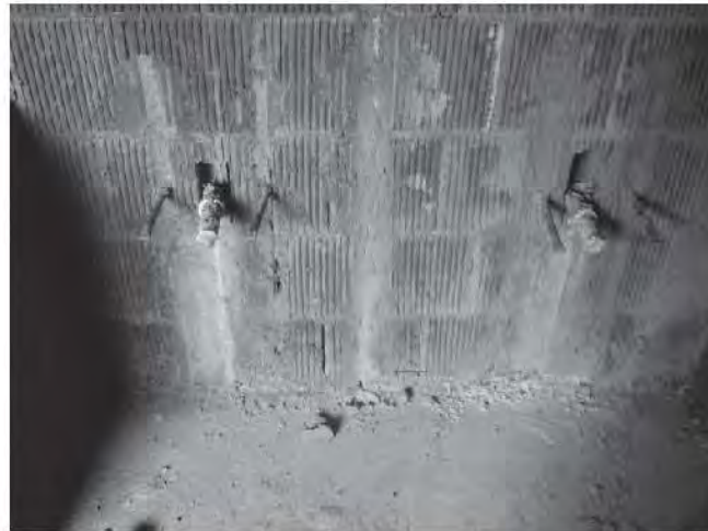
Fig. 4.2.1.8 Instalaciones hidráulicas en tabimax
