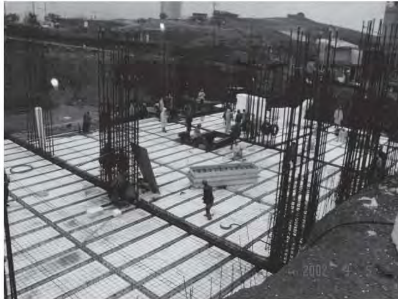
Fig. 5.3.5 Colocación de casetones y malla para el firme de compresión ejes 4 al 6 y A al E del nivel 89.50
