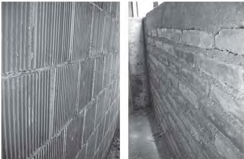
Fig. 4.2.1.2 y 4.2.1.3 Comparativa de rendimiento de mano de obra y material entre el tabique industrializado y el rojo recocido
