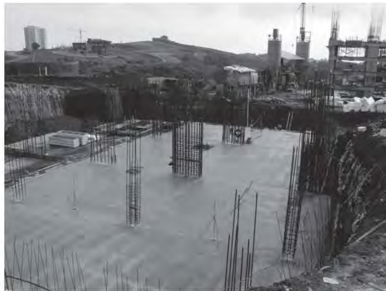
Fig. 5.3.6 Colado de la primera etapa de losa 89.50 ejes 4 al 6 y de A al E
