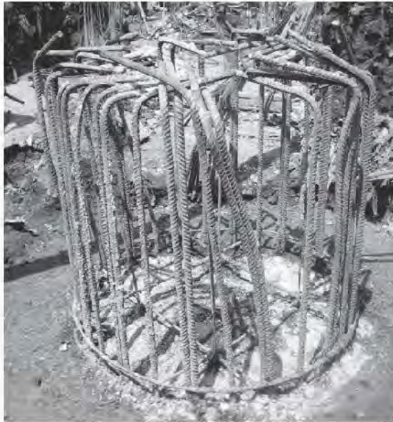
Fig.2.6.6 Pila descabezada con su acero reacomodado
