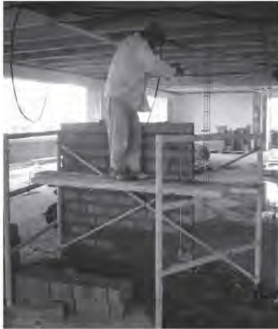
Fig. 4.21.1 Revisión de plomo y empleo de andamios para levantar muros de más de 1.5 m. de altura
