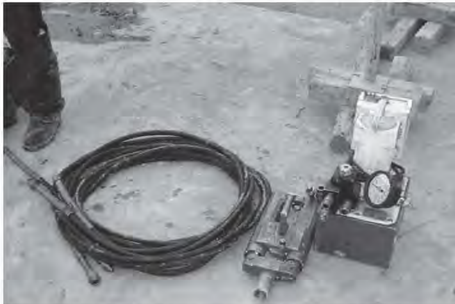
Fig. 3.8.7 Equipo para tensado; mangueras, gato y bomba
