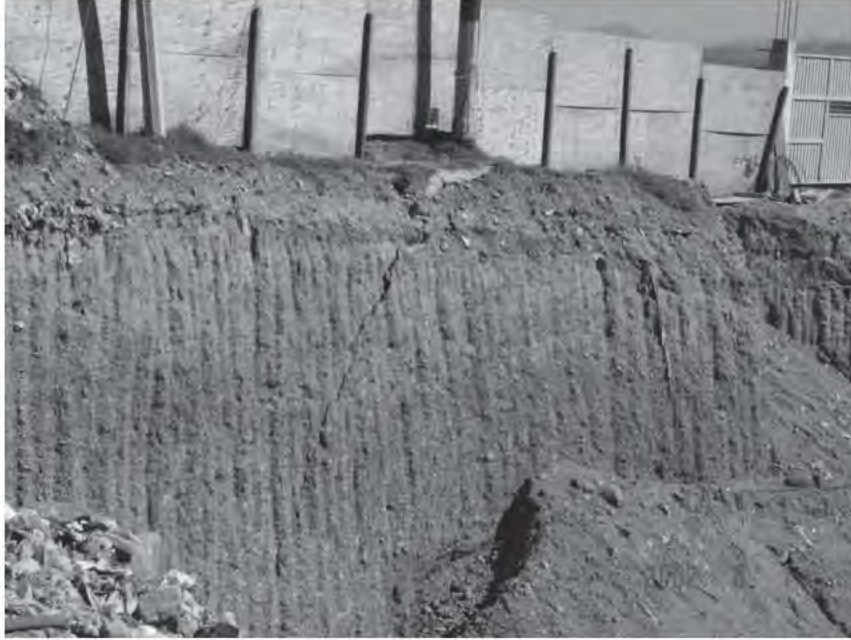
Fig. 5.1.4 Fisura cercana a poste y material suelto
