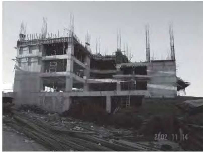
Fig. 5.3.9 Colado de la primera etapa de la losa 3 del eje C al E
