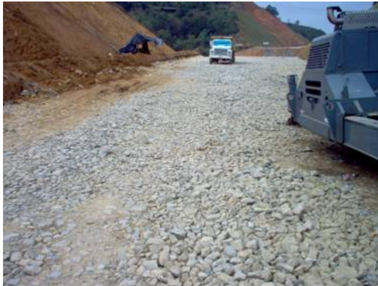
Fotografía 42: Presencia de colchoneo
