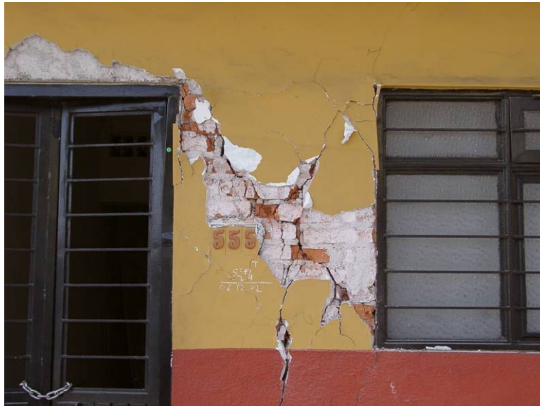
Falta de confinamiento. (falla por cortante)
