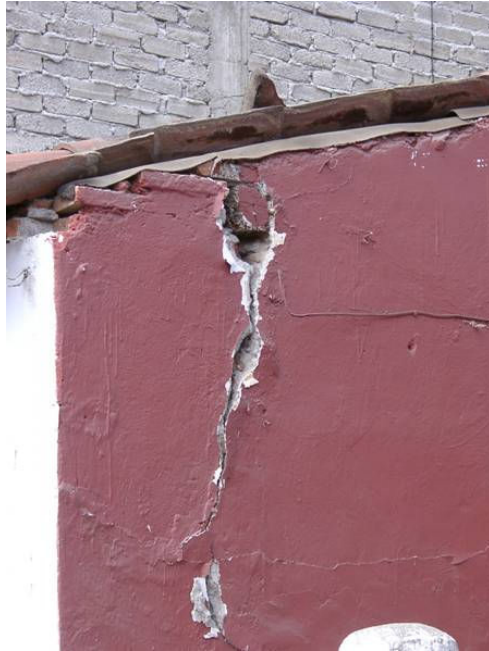
Falla por cortante
