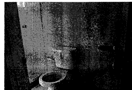
CASA MUESTRA INTERIORES- BAÑO
