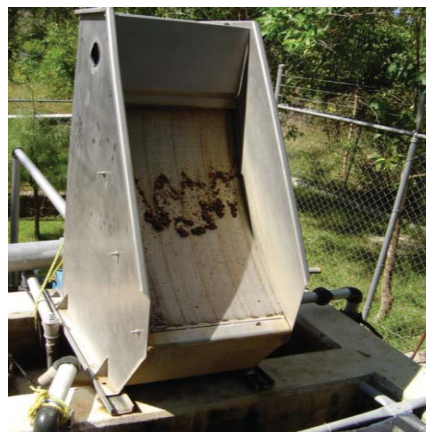
Equipo de tratamiento de aguas residuales
