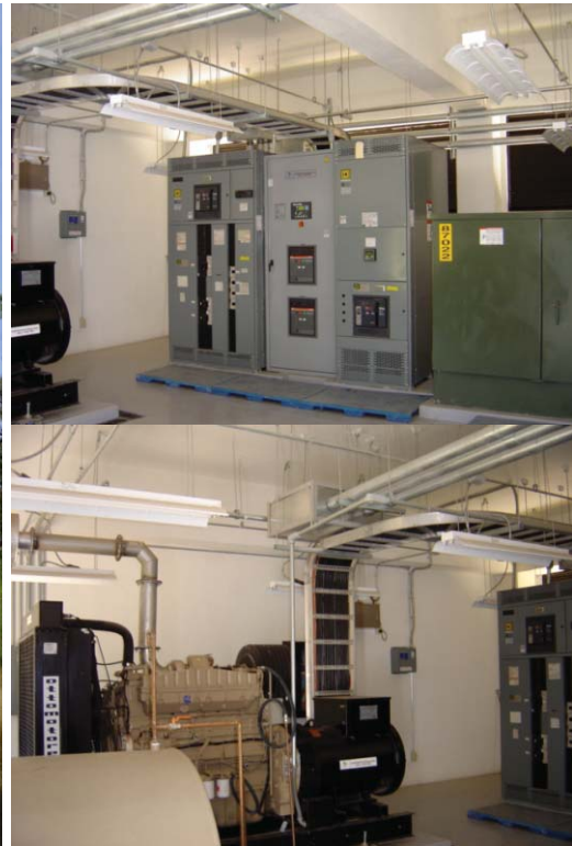
Planta de emergencia y subestación
