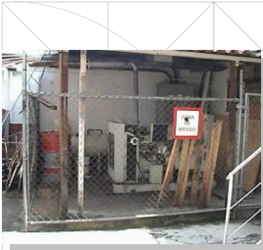
Grafico No. 33 La planta de luz, una zona de riesgo para los empleados y usuarios.
