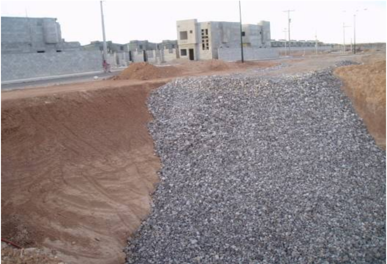
Fotos 98 y 99. Pozos de absorción de agua pluvial en Villas del real y Valle de Cántaros
