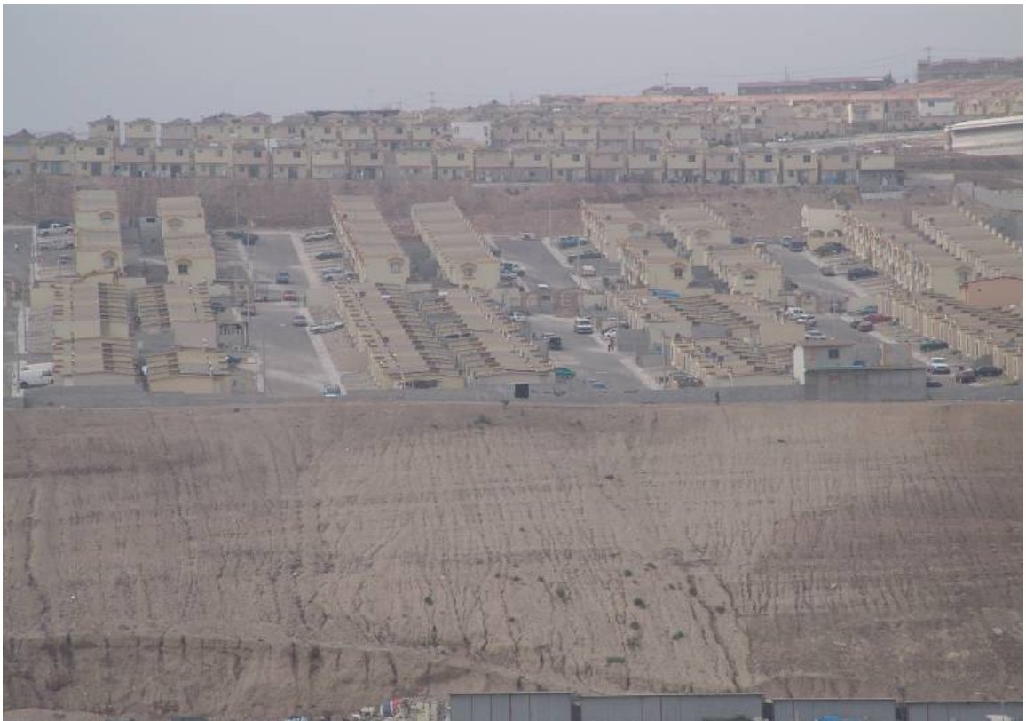
Foto 84. Talud de tierra sin vegetación que fije el suelo. Santa Fe, Tijuana.
