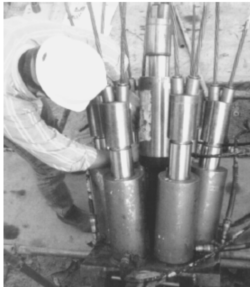
Fig. 10.7 Tensado de varios torones al mismo tiempo con el uso sincronizados de siete gatos hidráulicos
