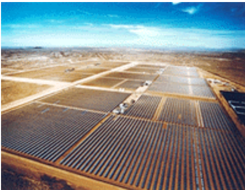
Sistemas tipo Canal Parabólico, Suroeste de California.
