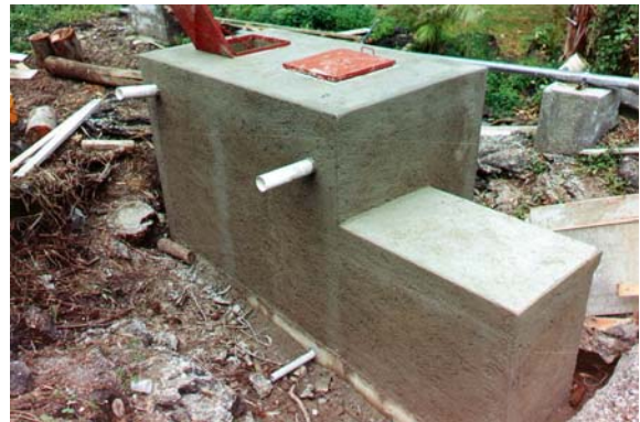
Figura A4.5 Tanque homogeneizador o segundo sedimentador del HAFVD
