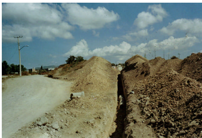
Canaletas para drenaje pluvial y sanitario Mayo del 2000.
