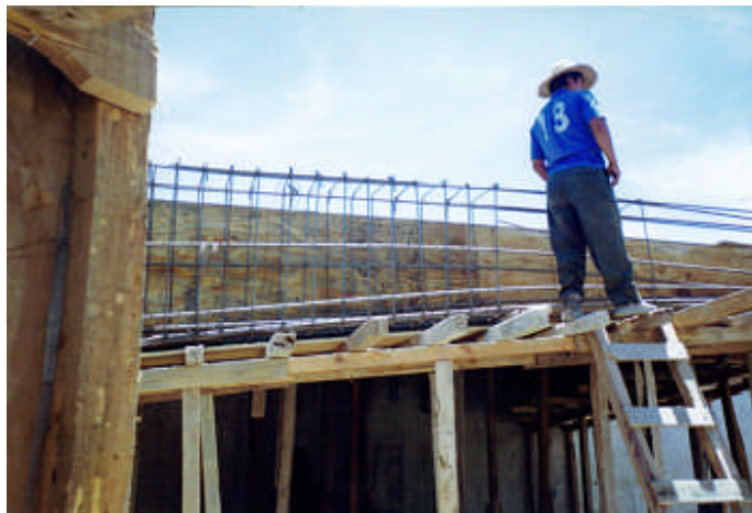
Armado y cimbrado de traves de liga, en el nuevo templo Parroquial San Agustín Tlaxiaca.
