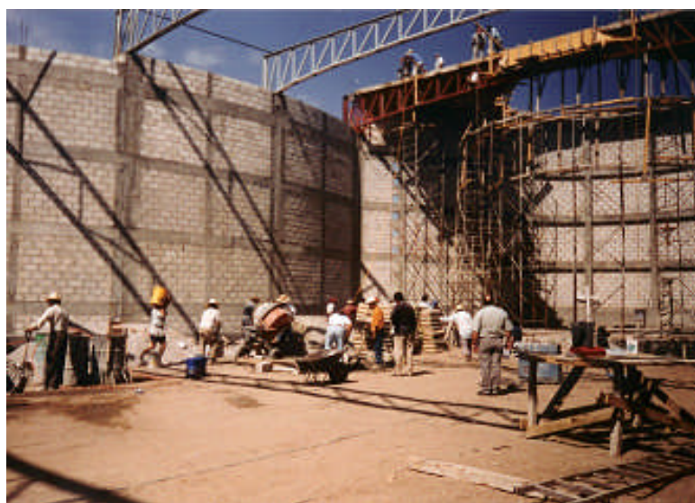
Grupo de albañiles Tlaxiaqueses preparando concreto para el colado de la primera etapa en el anillo del presbiterio del nuevo templo parroquial. 2002
