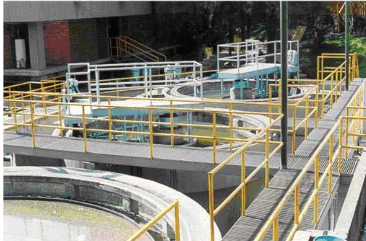
Fotografía 3.2 Sedimentadores de la planta de tratamiento de Ciudad Universitaria
