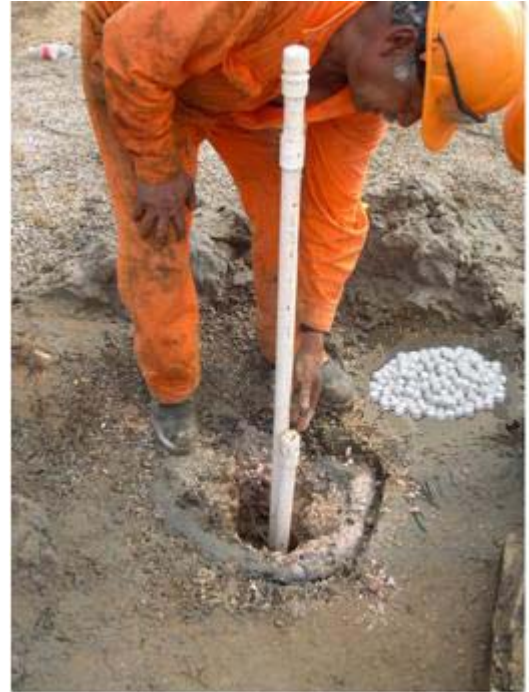
Figura No. 8.1 Construcción del piezómetro abierto, con dos bulbos. Aquí se muestra la colocación de bentonita en bolas para conformar el sello del segundo bulbo.
