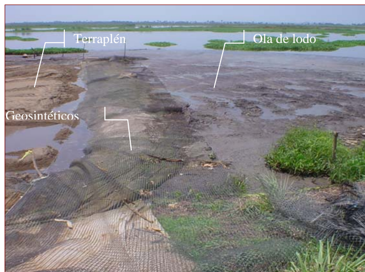
Figura No. 9.3. Ola de lodo generada por la construcción del terraplén.
