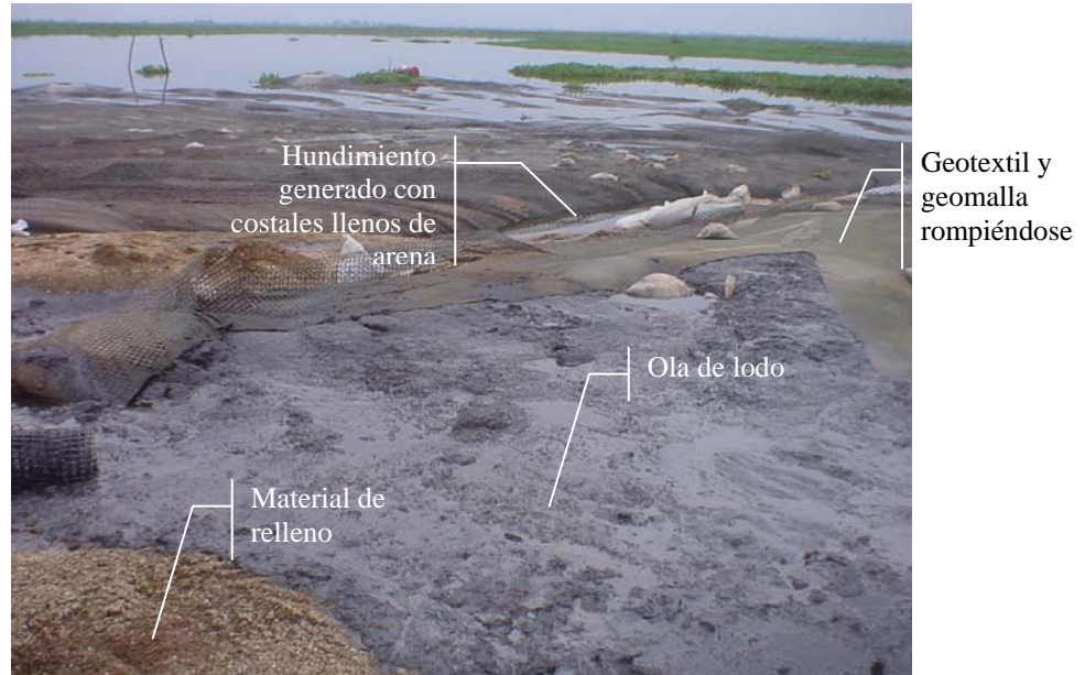
Figura No. 9.2. Falla de la primera capa de geosintéticos por la presión que genera la ola de lodo al no poder desplazarse libremente porque se colocaron costales llenos de arena en el frente de desplazamiento.
