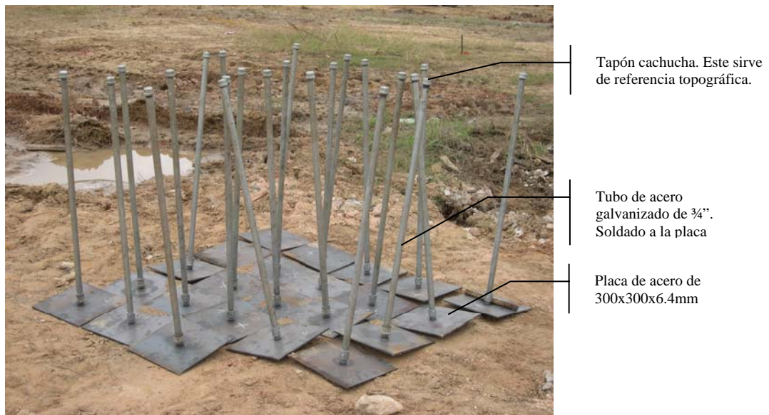
Figura No. 8.7 Placas para medir asentamientos del terreno de cimentación.
