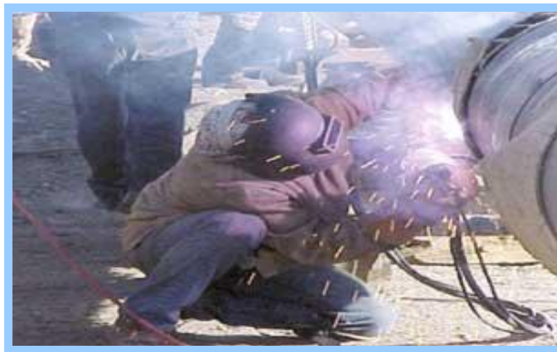
Figura 10. Ejemplo de la soldadura de tuberías de transporte de gas natural (cortesía de PEMEX).
