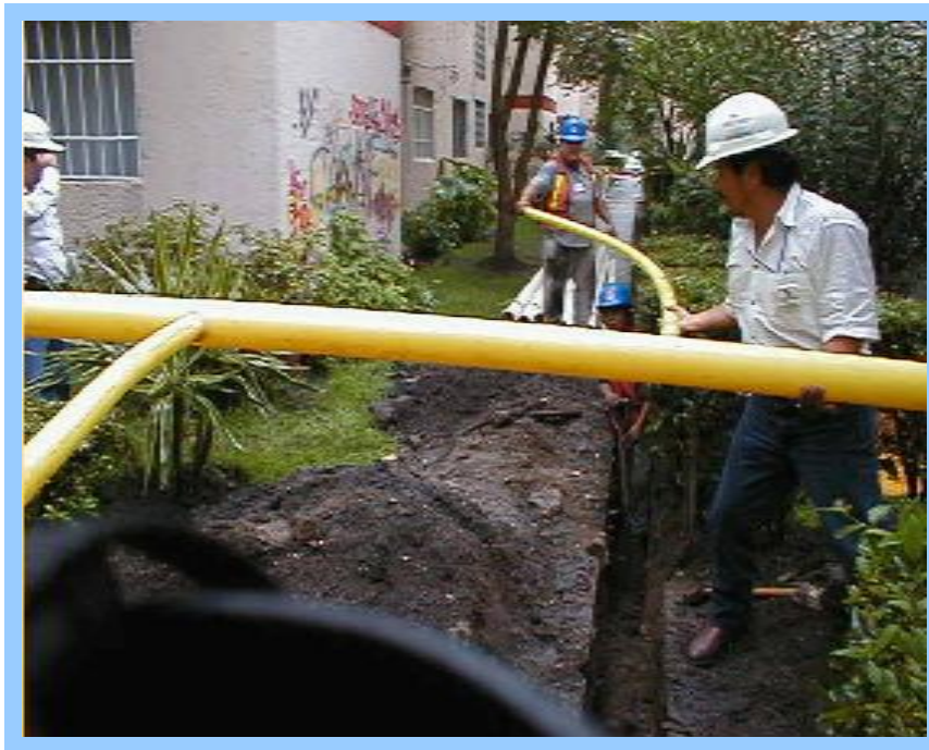
Figura 12. Ejemplo de de dos reducciones de tuberías secundaria a tuberías terciarias. (Cortesía de METROGAS).
