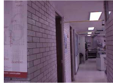
Fig. 9 No hay extinguidor.
