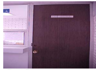
Fig. 6 Entrada no señalizada
