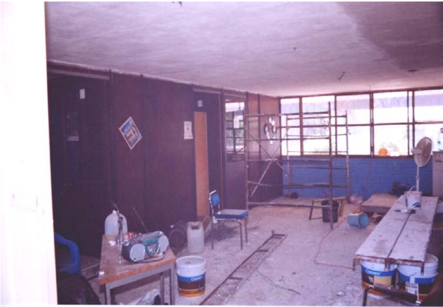
Lo que quedo de la estación 1
