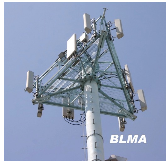
Figura I.21. Arreglo de dipolos para una BTS.
