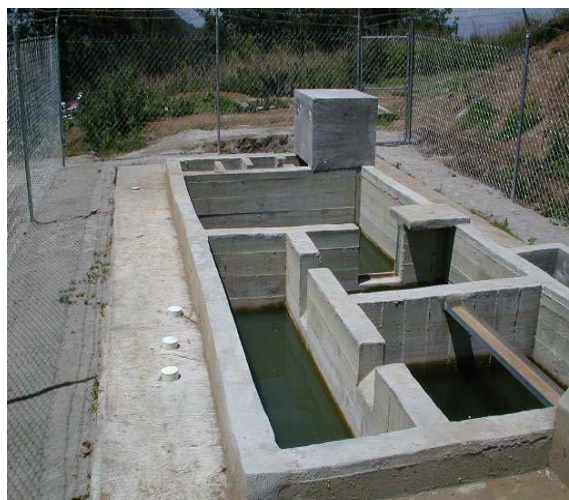
Filtros 1, 2, 3, tanque de recuperación de agua de lavado y caja de válvulas D1, vertederos y compuerta.
