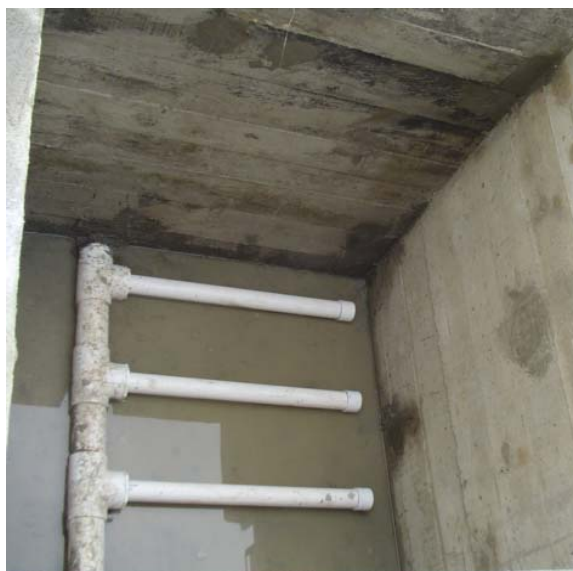
Ramal de PVC hidráulico RD-26 del filtro F2.
