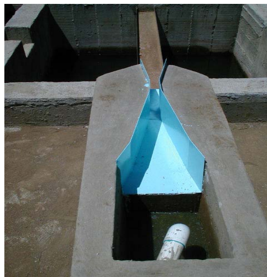
Canal Parshall y filtro F1
