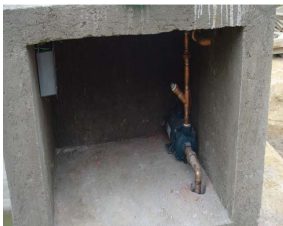
Caseta de protección de la bomba de 0.75 hp check y centro de carga con pastilla de 15 amp.
