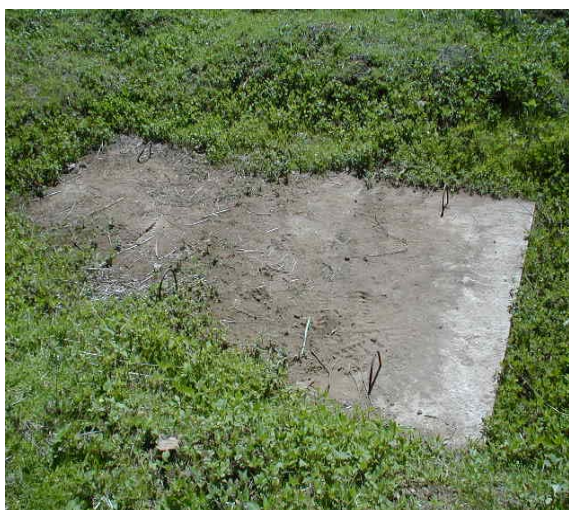
Sedimentador con tapa de concreto para evitar contaminar el agua.
