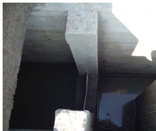
Tanque de contacto de cloro y su vertedero.
