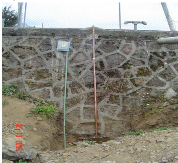
Caja de fusibles y tubería de PVC de la acometida eléctrica de la bomba, tubería de cobre de 1" de descarga de la bomba al tanque de distribución.
