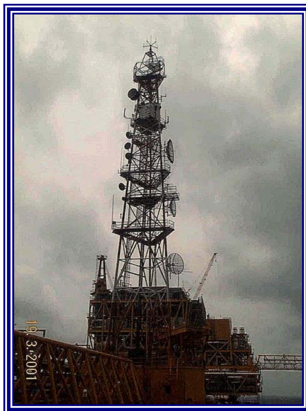
FOTO 21. TRÍPODE DE TELECOMUNICACIONES AKAL-C-5
