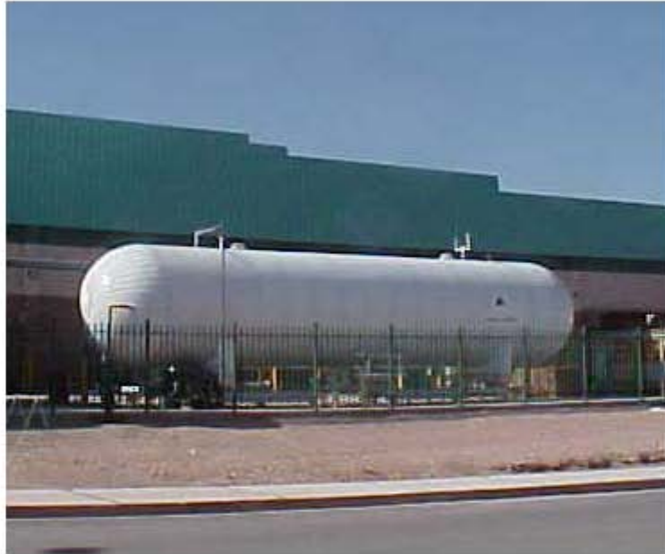
Figura 2.6.1 Tanque de almacenamiento de CO 2
