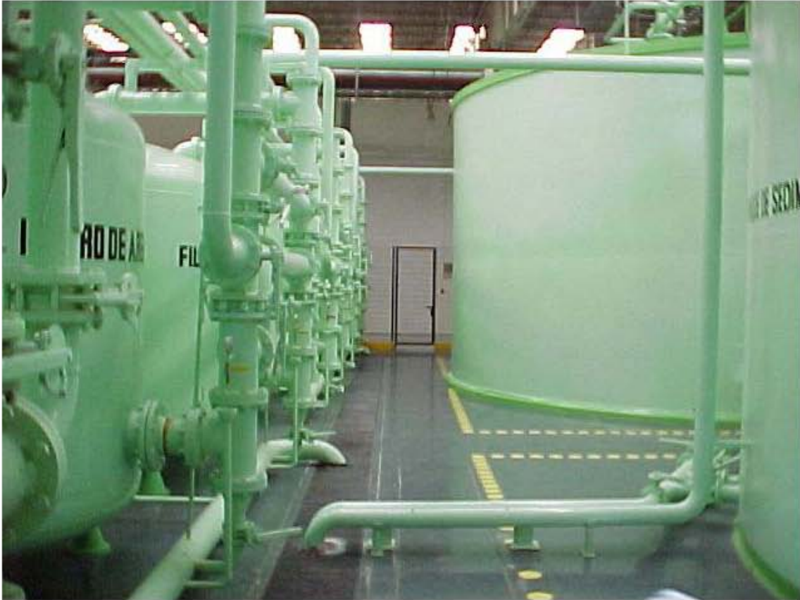
Figura 2.1.2 Tratamiento de agua con tanque coagulador y batería de filtros.
