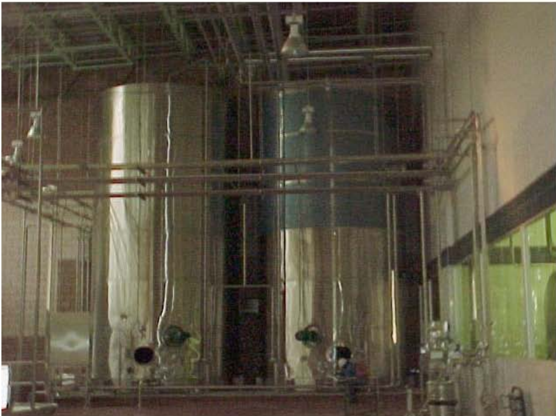
Figura 2.2.4 Tanques de almacenamiento de Alta Fructosa.
