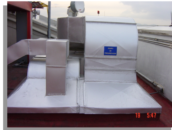
Sistema de Presurización
