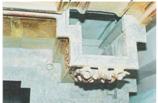
75. Basamento del banquillo y el resalto del entablamento formados con una caja de tablas adosada al bastidor, sus molduras pegadas al borde
