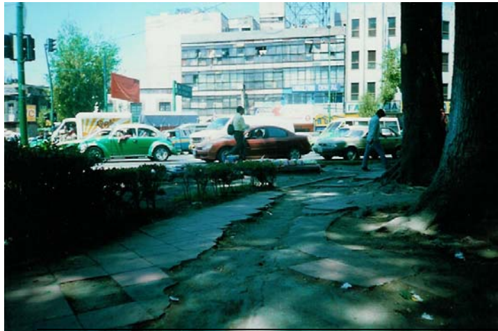
117 .- Raíces de árboles que están levantando las guarniciones y banquetas, en especial en la Plaza de San Pablo.
