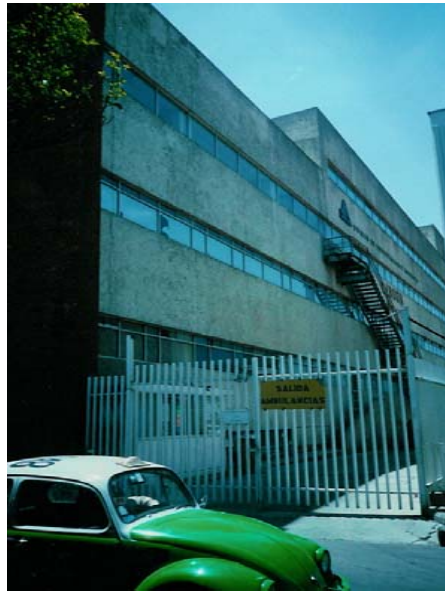
107.- Edificio de Cirugía de Corta Estancia en situación de abandono en el Hospital Juárez del Centro.
