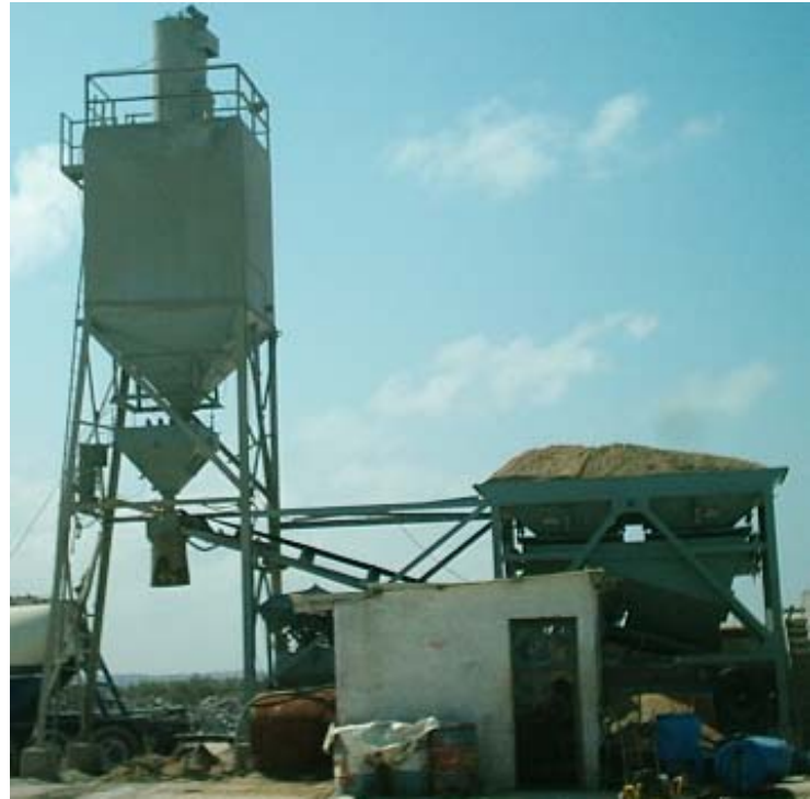
Figura 1.15 Vista general de la dosificadora.
