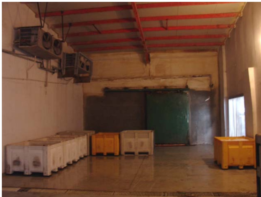
Figura III.15 Cuarto de refrigeración de productos pesqueros.
