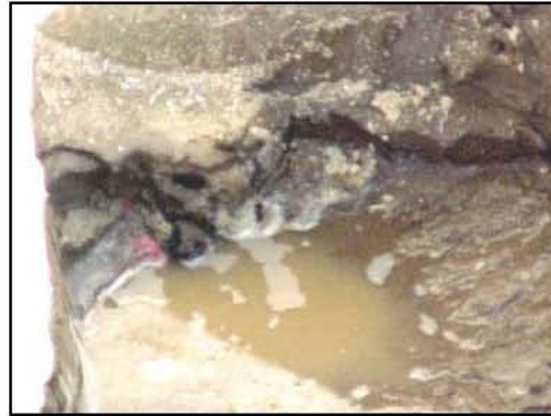
Obstrucción del desagüe, 120 min. en modelo.
