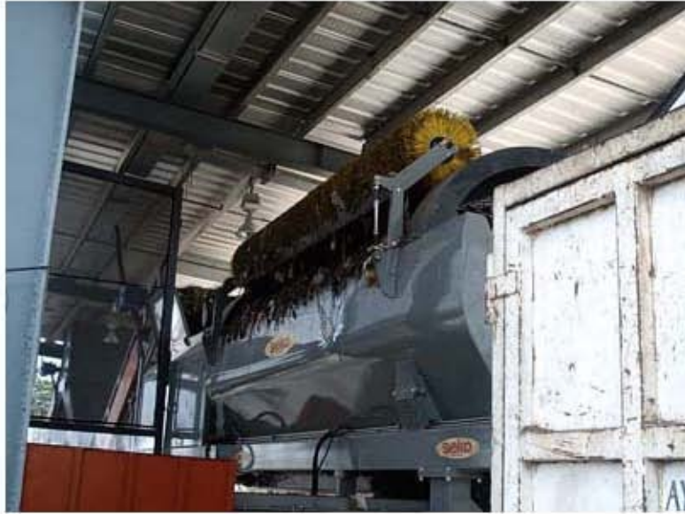
Figura 2.12. Rodillo limpiador del trommel
