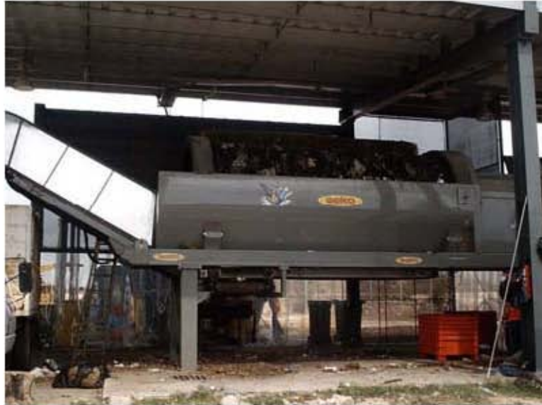
Figura 2.10 Trommel instalado en la planta de composta de Mérida
