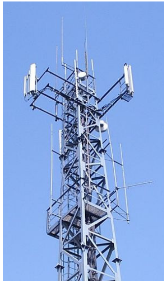
Figura 3.9 Estación Radio Base
