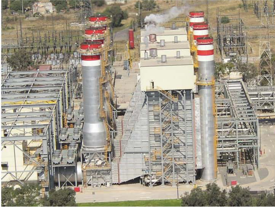
Figura 2.3 Chimenea de escape de las unidades turbogas
