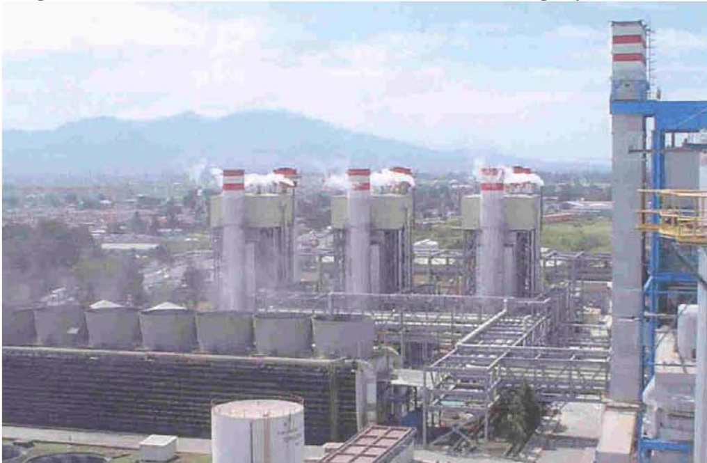
Figura 2.2 Ductos de conexión entre las unidades turbogas y la unidad 4
