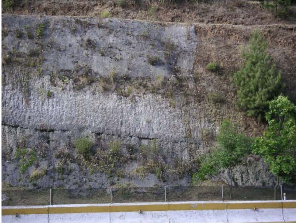
Foto 5 Vista de la Capa Dura en el sitio Lahar, la cual se observa en la porción media del corte acusando una dureza elevada comparable con la del concreto lanzado que cubre las tobas rojizas encima de ella.
