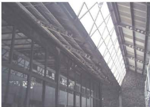
Toma panorámica de la nave donde se localiza parte de la maquinaria
