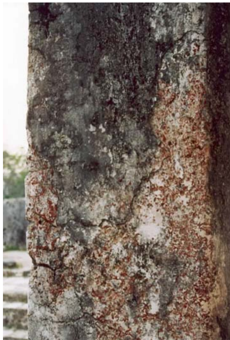
Figura 15. Detalle del desprendimiento del material.
