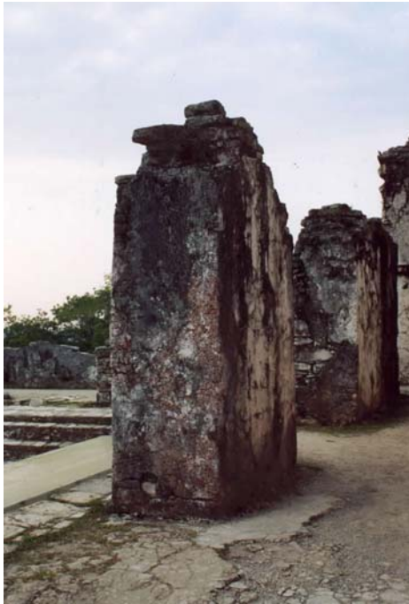
Figura 13. Vista de los crecimientos algales sobre muros.
