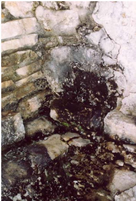
Figura 21. Detalle del desprendimiento del material.
