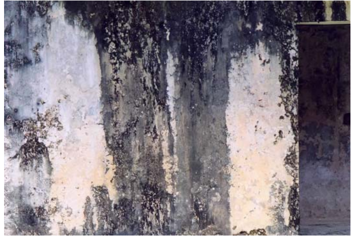
Figura 39. Vista del escurrimiento.
