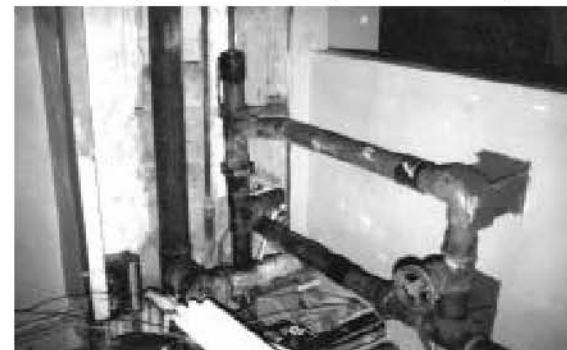
Fotografía 2.9. Tuberías rígidas inapropiadas ante deformación por vibración
