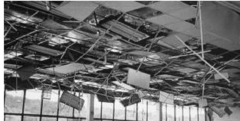
Fotografía 2.6 Daños en cielos rasos.
