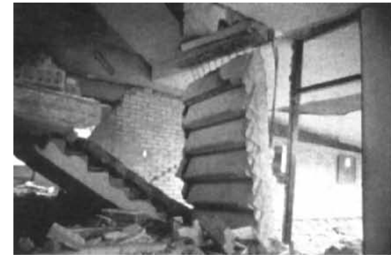
Fotografía 1.4 Colapso de escalera por falta de resistencia al sismo, que evita cualquier tipo de evacuación 1 .
