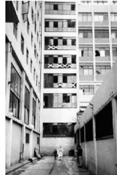
Fotografía 2.8 La ruptura de vidrios puede causar daños a los ocupantes del hospital, obstaculizar las vías de circulación y evacuación, así como perder las condiciones aislantes
