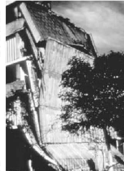
Fotografía 2.2. Colapso Estructural debido a la discontinuidad de elementos Estructurales*
