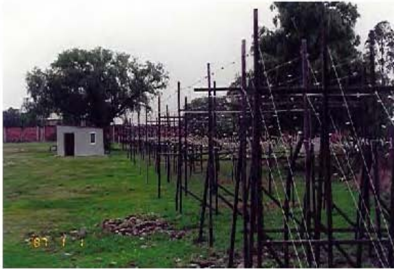
Figura 20: Vista longitudinal del arreglo prototipo, donde se muestran las 4 líneas de dipolos que lo conformaban y la caseta de recepción de señal.
