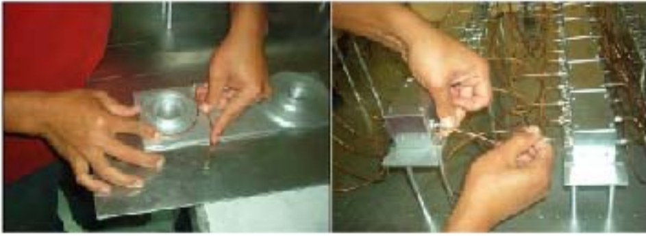
Figura 6: (a) Doblado de los cables coaxiales semirrígidos. (b) Interconexión de los dispositivos y detalle de doblado entre las etapas.
