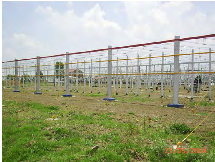
Figura 25: Detalle de la estructura de soporte del arreglo dipolar. Las columnas de concreto soportan el arreglo de 3 perfiles metálicos: el perfil superior recibe la tensión de los dipolos; el perfil intermedio soporta y da estabilidad a la pantalla reflectora; el perfil inferior soporta la tensión de las líneas de transmisión.
