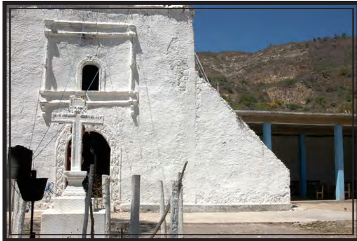
Fig. 43 Contrafuerte de forma trapezoidal de la visita de Hualula (foto: Eumelia Hernández)
