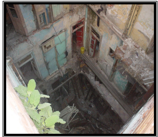
PATIOS INTERIORES (DETERIORADOS)
