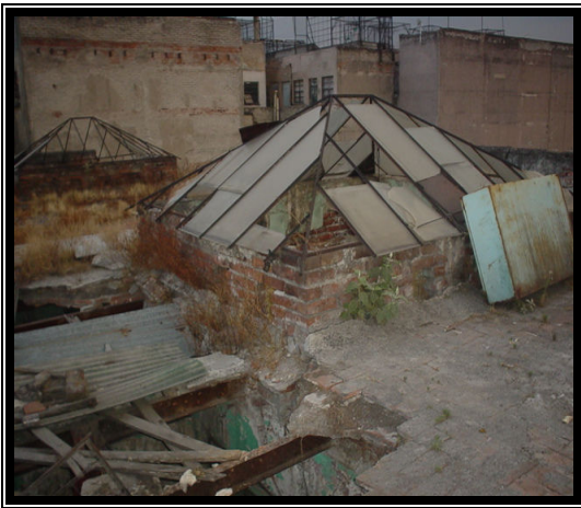
ESTADO ACTUAL DE AZOTEA (DETERIORADOS)
