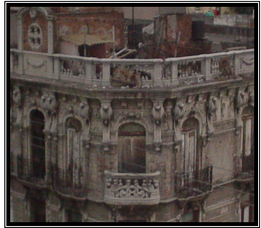
SE APRECIA EL DETERIODO GENERAL EN LA FACHADA
