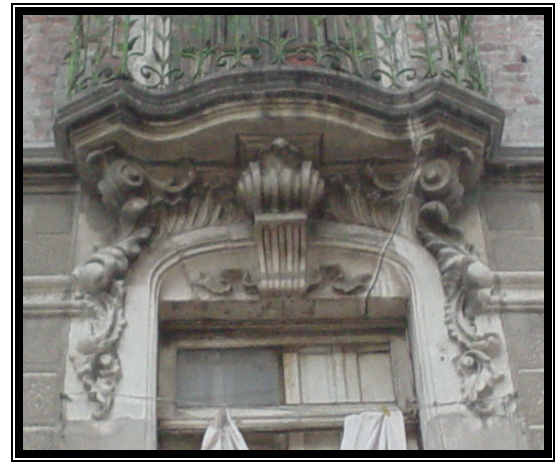
SE OBSERVA EL FISURAMIENTO EN LA FACHADA
