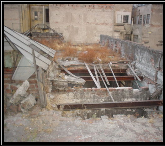
FOTO QUE MUESTRA LA CAIDA DE AZOTEA DEL LADO SUR
