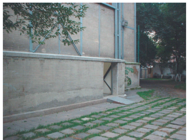
Salida de emergencia carente de señalización.
