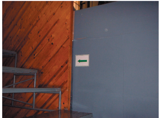
Señalización vieja y colocada en un lugar incorrecto.
