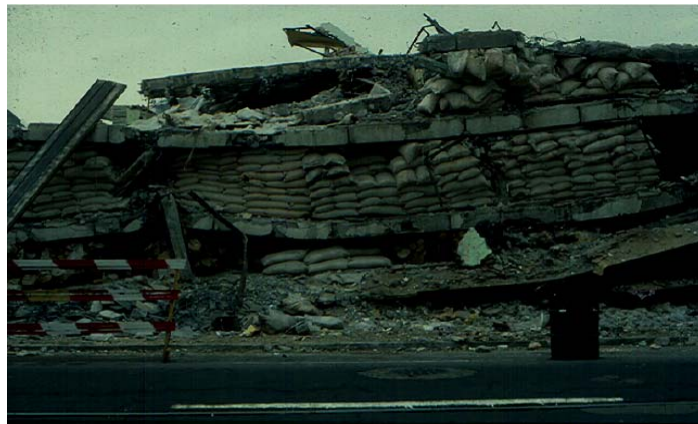
Figura 8: Colapsos de estructuras por flexiones y deflexiones intolerantes (18)
