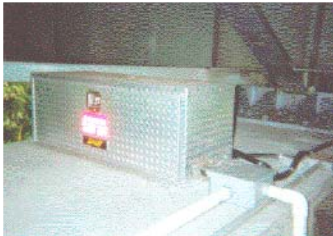
Figura 22: caja de monitoreo central del sistema estructural del edificio (Imagen tomada de una caja de monitoreo por Dr. en Ing. A. Mufti)
