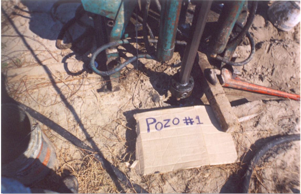
FOTO16. Se presenta el momento de perforación en el Sondeo Mixto la SM-1, el cual se realizó mediante el penetrómetro estándar y un tubo shellby para la muestra representativa No. 4.
