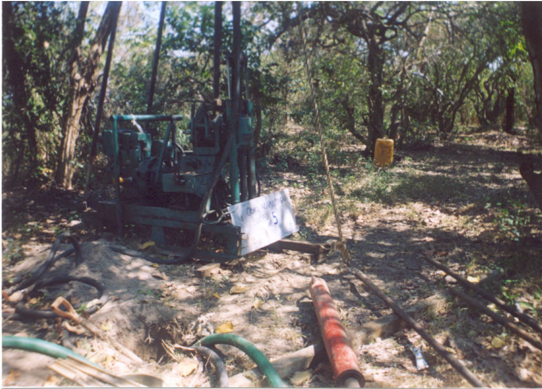
FOTO23. En la zona donde se realizó el Sondeo SPT-5, es muy abundante la vegetación y la capa vegetal aumente hasta los 25cm de espesor.
