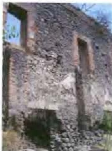
Cruja norte desprendimiento de elementos pétreos y juntas
