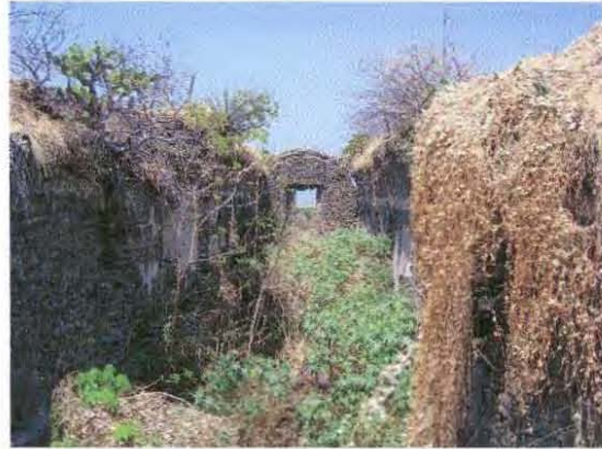
Vista Interior de la Crujía Norte, con cubierta y entrepiso colapsados 186
