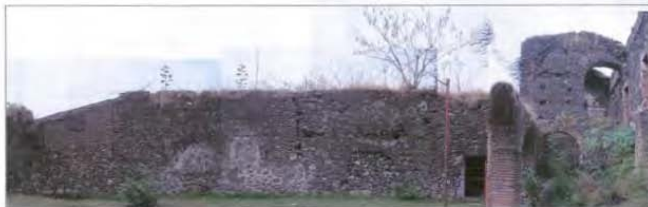
Larguillo de la fachada Oeste que ha hacia el claustro.
