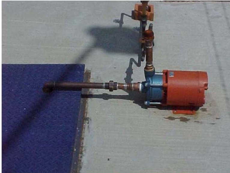
Figura 4.2: Fotografía de la Bomba y filtro.
