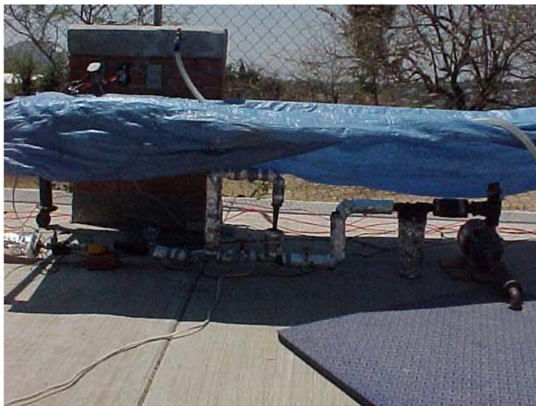
Figura 4.3: Fotografía del Bypass.
